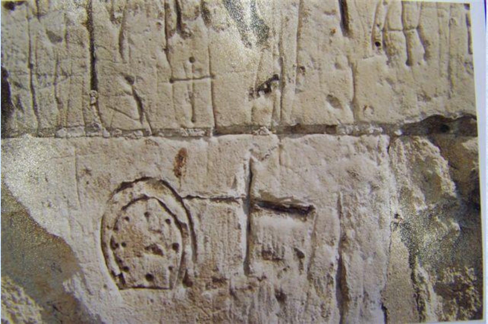
Graffiti sur le mur de l'église
